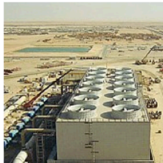
Impianto Uno degli impianti di raffreddamento realizzati da Spig per la Saudi Aramco. Il 90% del fatturato dell'azienda è realizzato all'estero
